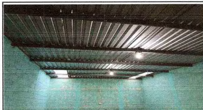
Foto 3: Es necesario la instalación de cielo falso de las aulas del segundo nivel, para poder disminuir el calor en verano, y el frío en época de invierno.
