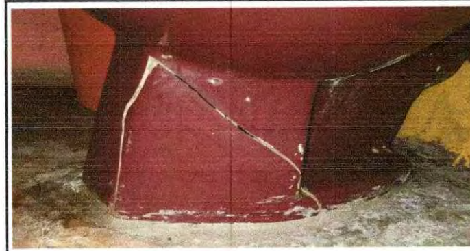
Foto 12: 4 tazas de inodoros se encuentra en mal estado, y se necesitan cambiarlos para prevenir algún accidente o enfermedad por el agua que se filtra en ellos.
