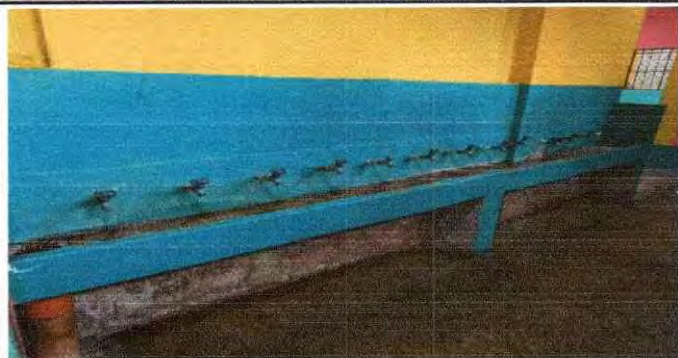
Foto 13: Se necesita instalar azulejos en lavamanos y paredes de los sanitarios, para que el agua no se filtre en la pared y provoque humedad.
