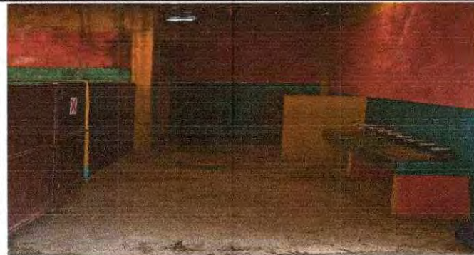
Foto 14: El piso de los sanitarios se debe de cambiar e instalar azulejo antideslizante, para evitar accidentes con los estudiantes.
