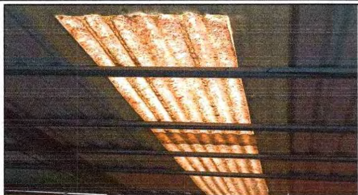
Foto 1: La cubierta de lámina del segundo nivel se encuentra en mal estado, en épocas de lluvia, el agua se filtra.
