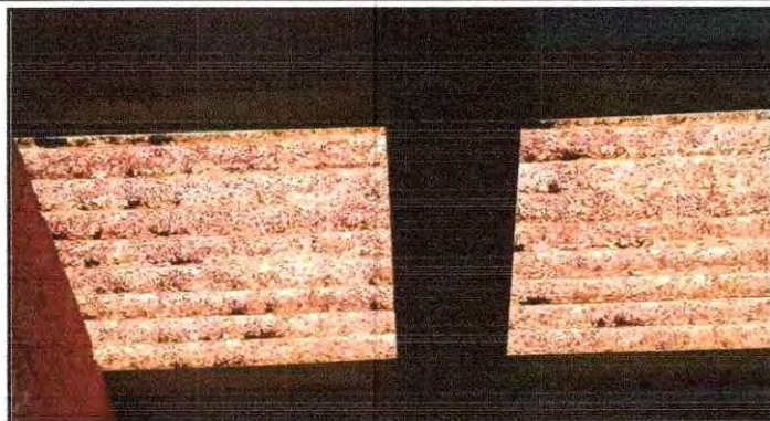
Foto 2: Es necesario hacer el cambio de láminas del segundo nivel, ya que el salón es utilizado para actividades culturales de la escuela.
